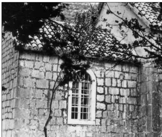
Sjeverni zid glavne kapele. Raspoznaje se noviji dio zida oko naknadno proširenog prozora
